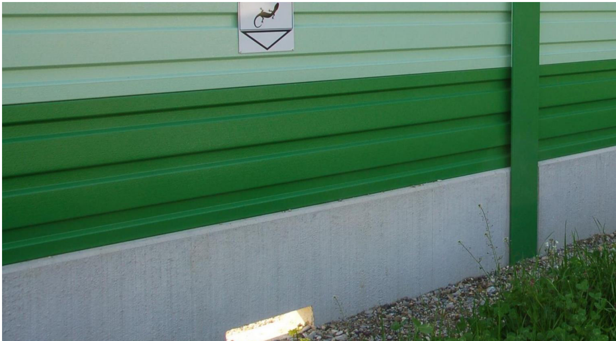
Abbildung 2: Beispiel einer Lärmschutzwand mit freigelassener Öffnung für Eidechsen als Verbundmöglichkeit von Habitaten.
